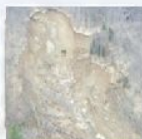
Frana di Pian dei Sisi
